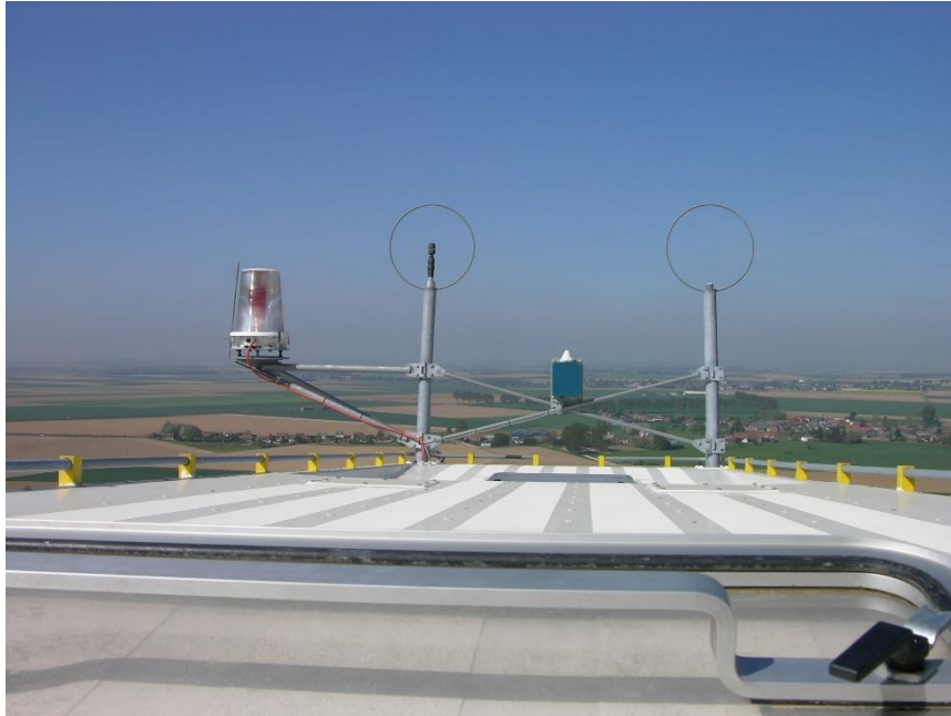
Photo d'un balisage installé en nacelle
